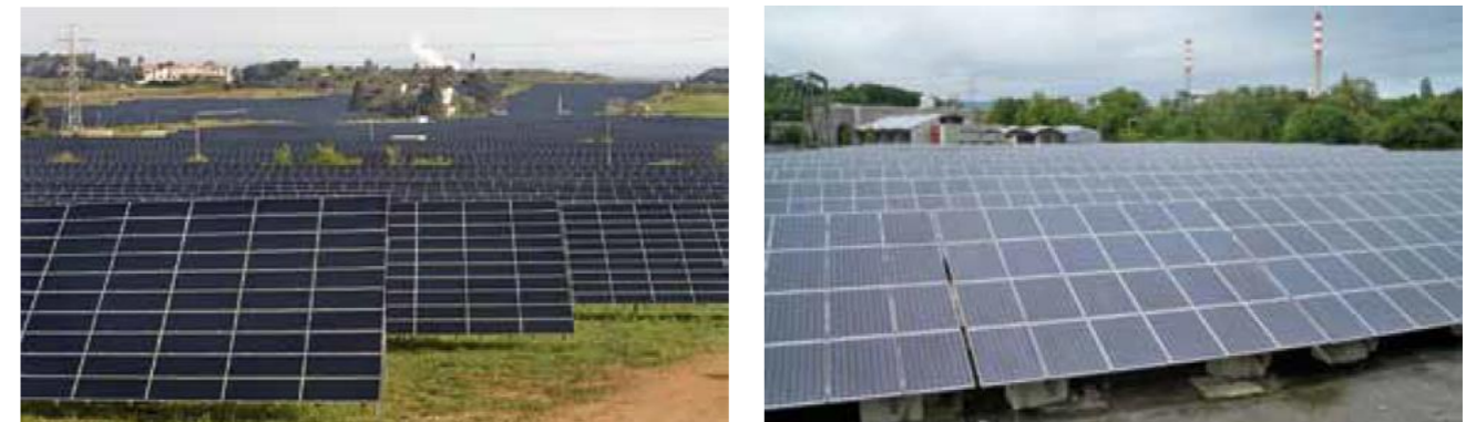
Photo 1 : installations fixes au sol
