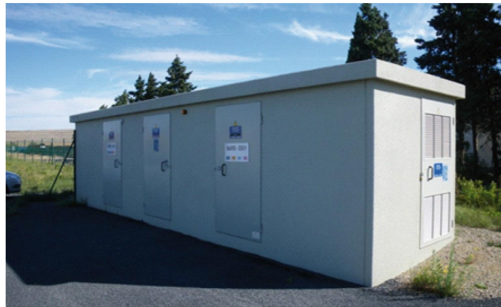
Photo 2 : Exemple d'un poste de livraison
